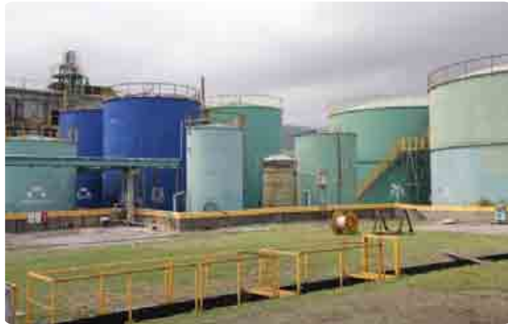
硫酸、鹽酸、重油儲槽及防溢堤
