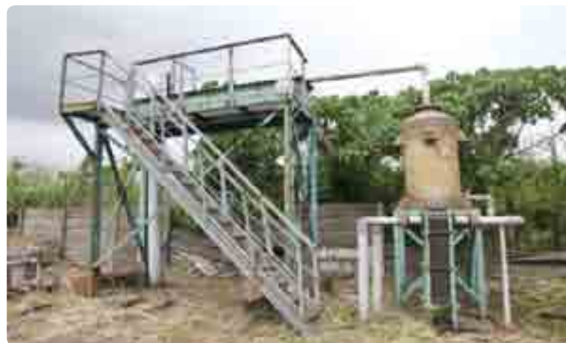
蘇澳廠D-01排放水排放系統
