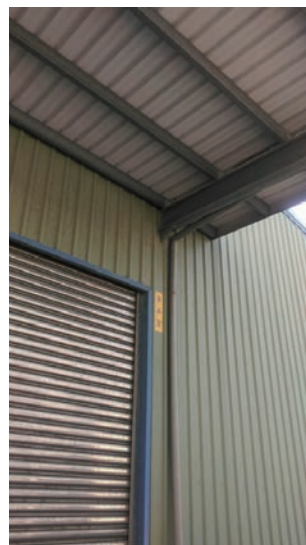
台中廠食品倉庫
