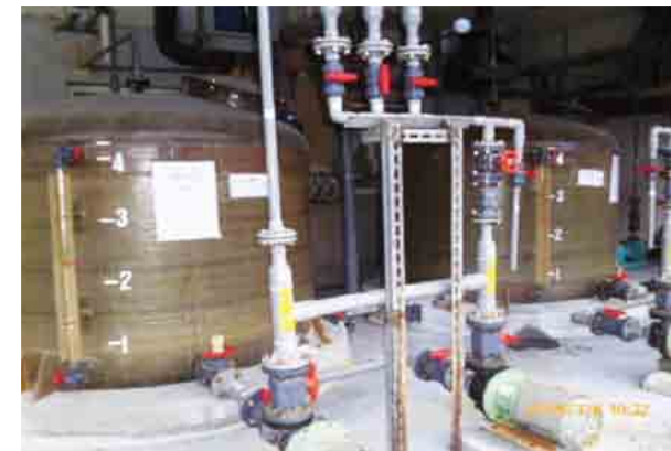
化學品儲槽、管路、管閥標示
